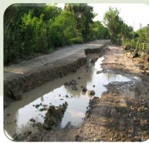
OBRAS CON DEFICIENCIAS TÉCNICAS
