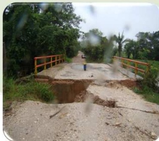
OBRAS CON DEFICIENCIAS TÉCNICAS
