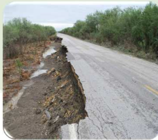
OBRAS CON DEFICIENCIAS TÉCNICAS
