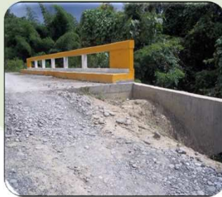
DEFICIENCIAS TÉCNICAS CONSTRUCTIVAS
