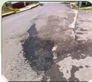
OBRAS CON DEFICIENCIAS TÉCNICAS
