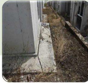
DEFICIENCIAS TÉCNICAS CONSTRUCTIVAS
