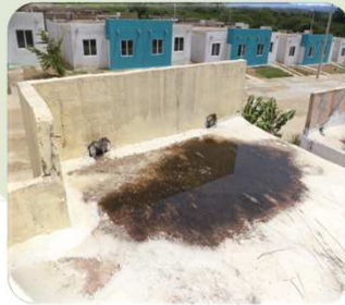
DEFICIENCIAS TÉCNICAS CONSTRUCTIVAS
