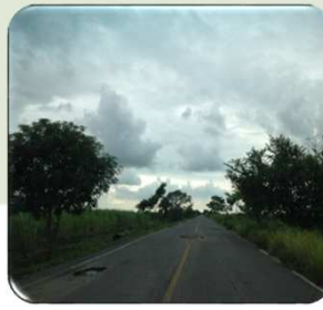
OBRAS CON DEFICIENCIAS TÉCNICAS
