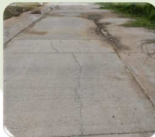
DEFICIENCIAS TÉCNICAS CONSTRUCTIVAS
