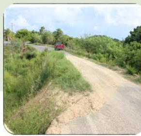
OBRAS CON DEFICIENCIAS TÉCNICAS
