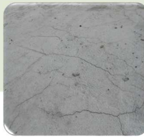
DEFICIENCIAS TÉCNICAS CONSTRUCTIVAS
