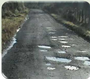
OBRAS CON DEFICIENCIAS TÉCNICAS
