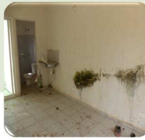
DEFICIENCIAS TÉCNICAS CONSTRUCTIVAS
