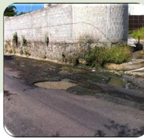
OBRAS CON DEFICIENCIAS TÉCNICAS
