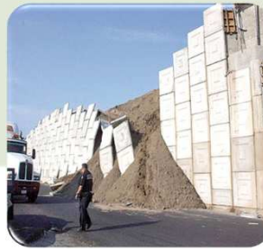
DEFICIENCIAS TÉCNICAS CONSTRUCTIVAS
