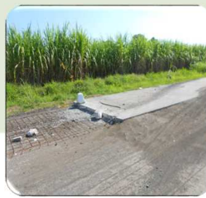
DEFICIENCIAS TÉCNICAS CONSTRUCTIVAS
