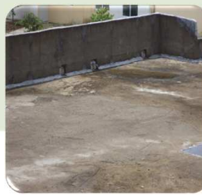
DEFICIENCIAS TÉCNICAS CONSTRUCTIVAS
