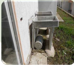
DEFICIENCIAS TÉCNICAS CONSTRUCTIVAS
