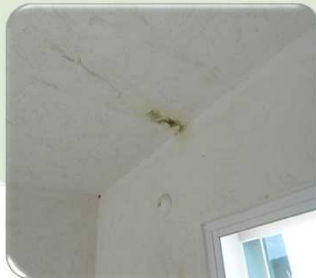
DEFICIENCIAS TÉCNICAS CONSTRUCTIVAS
