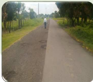
OBRAS CON DEFICIENCIAS TÉCNICAS
