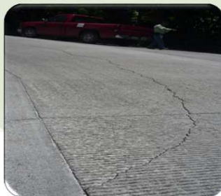
DEFICIENCIAS TÉCNICAS CONSTRUCTIVAS
