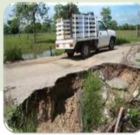
OBRAS CON DEFICIENCIAS TÉCNICAS
