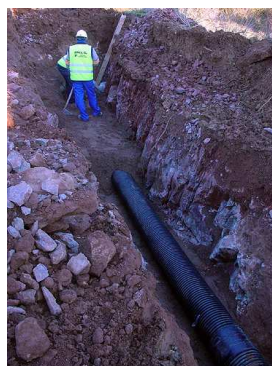
Excavación por medios manuales terreno tipo A a profundidad de 0.00 a 0.40 m., incluye: mano de obra, equipo y herramienta.
